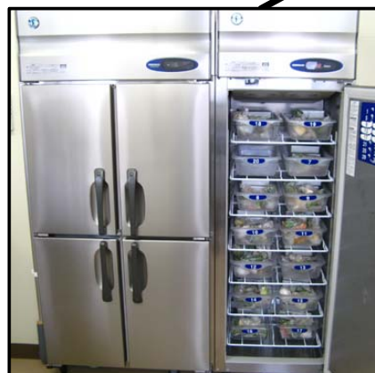
冷凍・冷蔵庫
